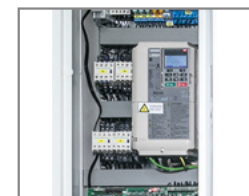
Quadro di manovra Impianto Mrl
