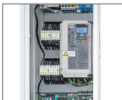
Quadro di manovra Impianto Mrl
