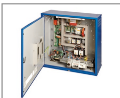
Quadro di manovra Impianto oleodinamico
