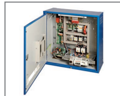
Quadro di manovra Impianto oleodinamico
