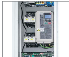
Quadro di manovra Impianto Mrl
