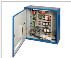
Quadro di manovra Impianto oleodinamico
