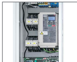
Quadro di manovra Impianto Mrl
