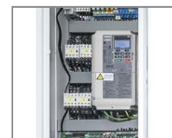
Quadro di manovra Impianto Mrl
